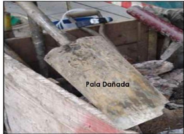
Fotografía 2: Pala dañada por el contacto eléctrico.
